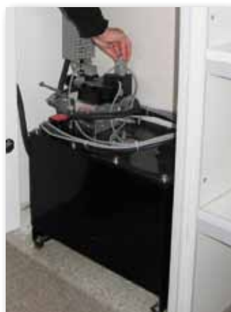
Commande de secours manuelle sur centrale hydraulique
